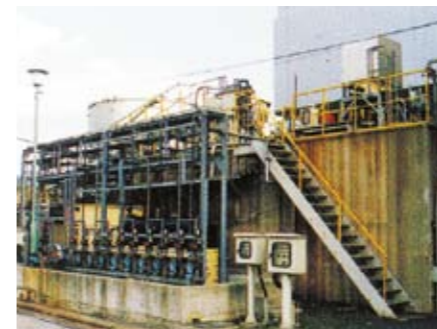
(工場の除害しせつ)
